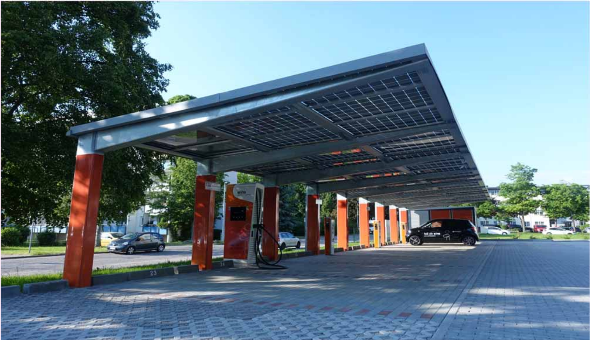
Chemnitz, Deutschland – 22 kWp – 120m 2
