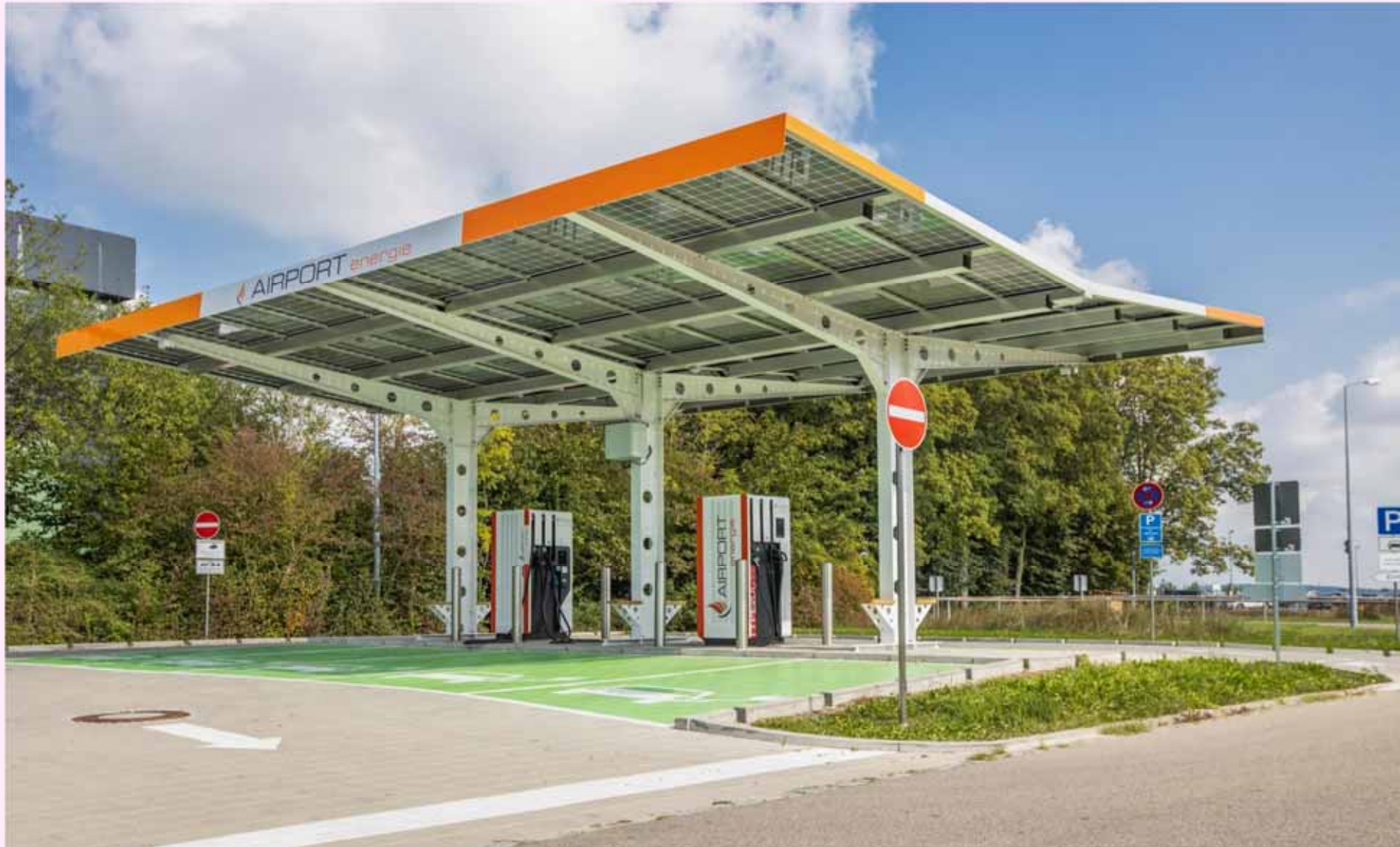
Flughafen Memmingen, Deutschland – 25 kWp – 140m 2
